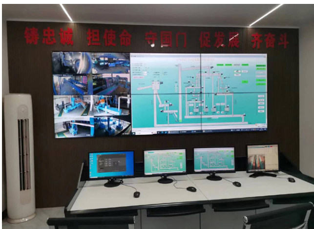
矿石、煤炭自动化采制样系统集控室
